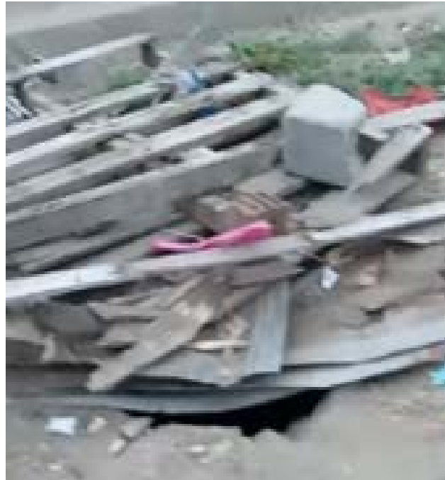
LA ZONA AFECTADA QUE FUE TAPADA POR LOS MORADORES CON PALOS Y OTROS ELEMENTOS.
