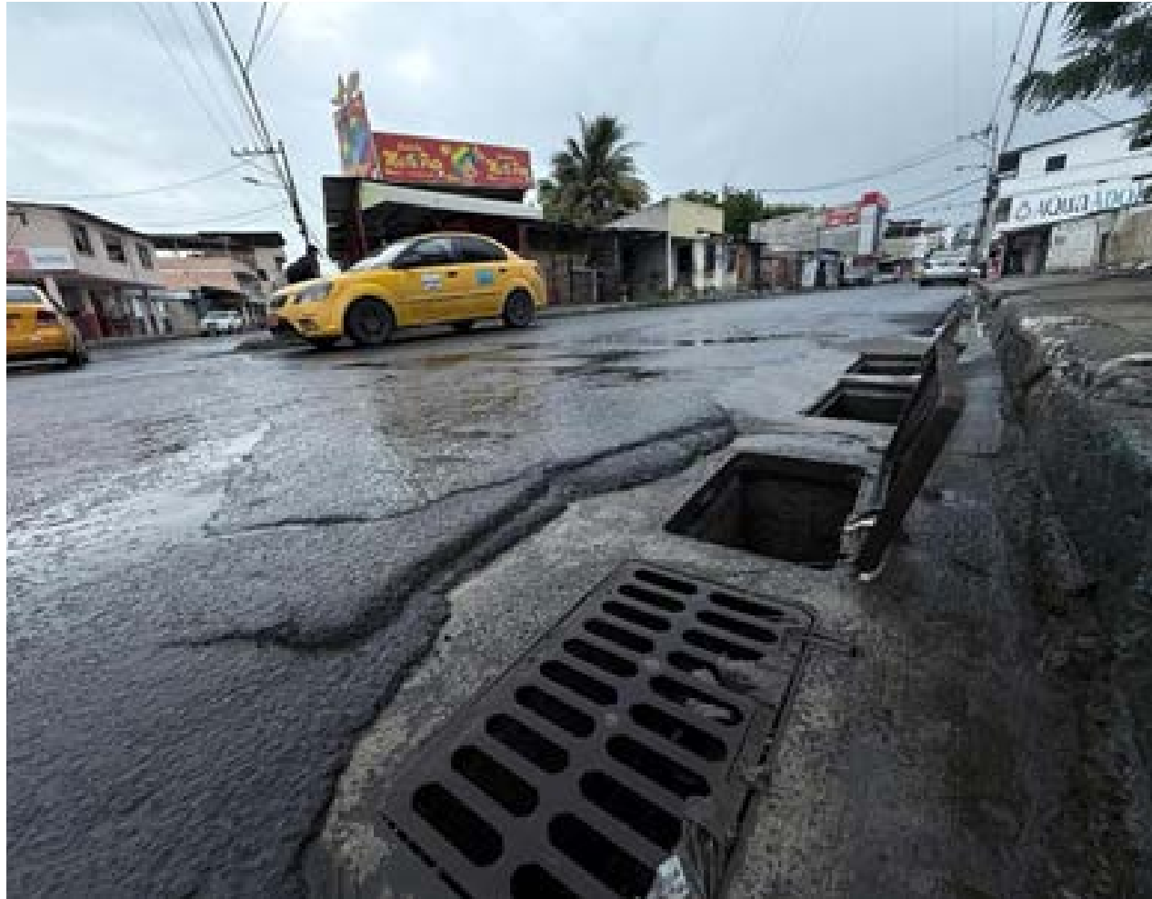
El nuevo sistema de alcantarillado de Manta en acción, permitiendo el flujo oportuno de agua en la intersección de la avenida 4 y calle 7.
