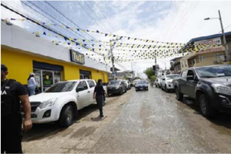
La obra de colector de aguas lluvias en el barrio Costa Azul, Manta, evitó la inundación en la zona durante la reciente lluvia.
