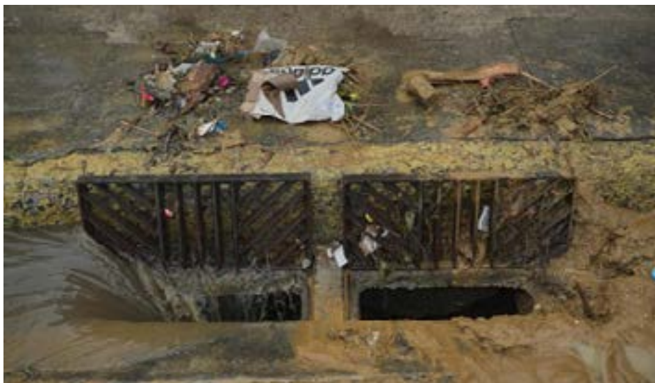
Sumidero en la vía Puerto-Aeropuerto siendo limpiado tras la obstrucción por desechos domésticos.
