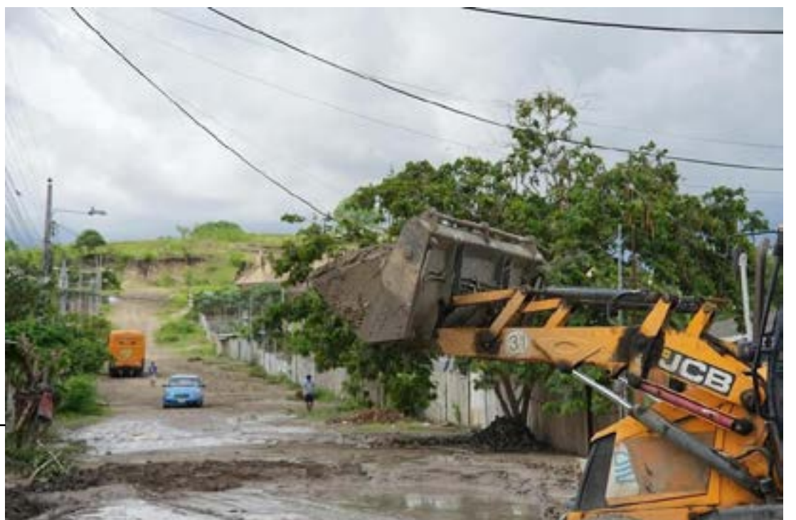
Lugar afectado por el desprendimiento de tierra y lodo en Urbirríos 2.
