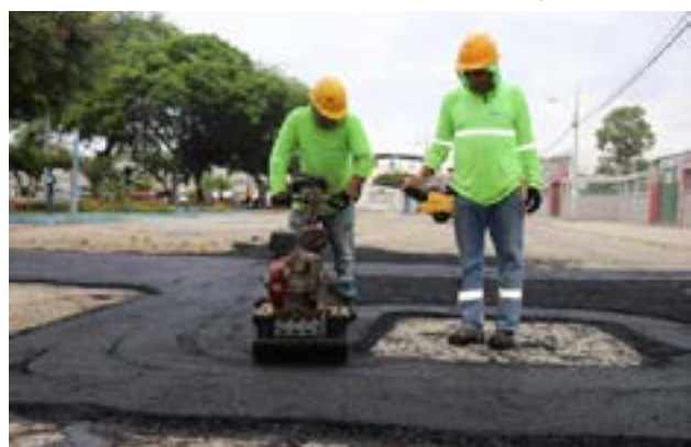
Equipos de Aguas de Manta en pleno proceso de reparación y reposición de aceras, mejorando la accesibilidad y el entorno de la ciudad.
