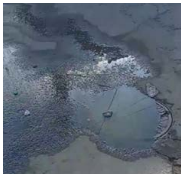
El morador del barrio 4 de Noviembre denuncia el rebalse de la alcantarilla, que sigue afectando la calidad del entorno y la salud pública.
