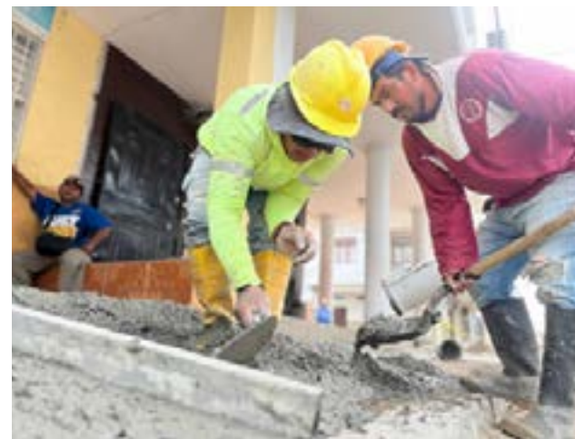
Reposición de calles realizada por Aguas de Manta durante el año 2024, garantizando la seguridad y funcionalidad de la infraestructura urbana.
