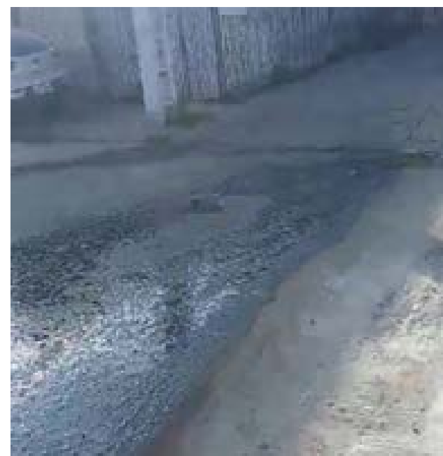
Residuo visible sobre la alcantarilla, situación que persiste a pesar de los trabajos de limpieza realizados en los últimos días.
